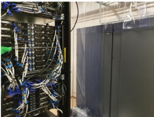
Kuva 6.1. Uusi konesaliympäristö KAMK:lla.
