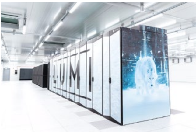
Kuva 9.1. LUMI-supertietokoneen ensimmäisiä osia uuden datakeskuksen sisällä.
